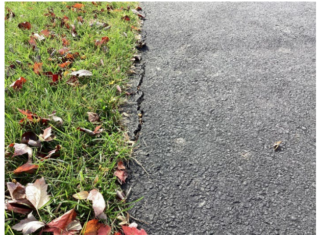
Edge deterioration (Annabelles Green)
